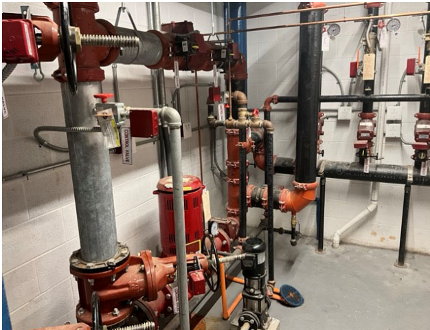
33 - FIRE SPRINKLER RISERS
